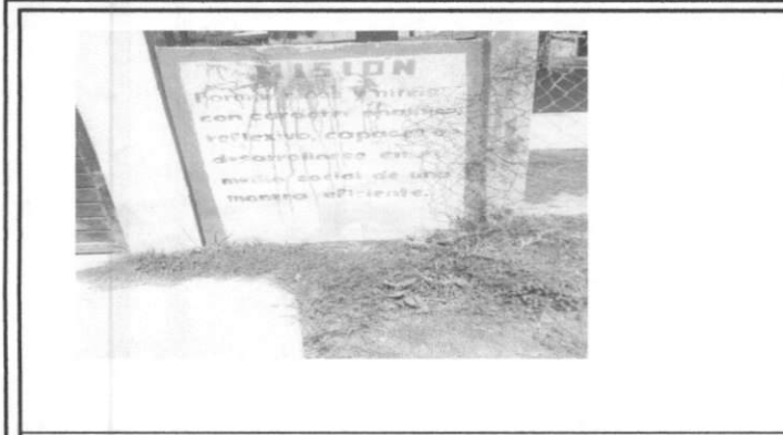
Foto 1: Pintura de los muros de la escuela, identificación, pintura en mal estado casi en el 90 por ciento de los ambientes
